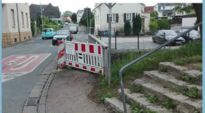
Die SPD hat im Ortsbeirat der Kernstadt die Sanierung der Fußgängerbrücke in der Rudolf-Dietz-Straße und der davor liegenden „Kaiser-Wilhelm-Anlage“ gefordert.
